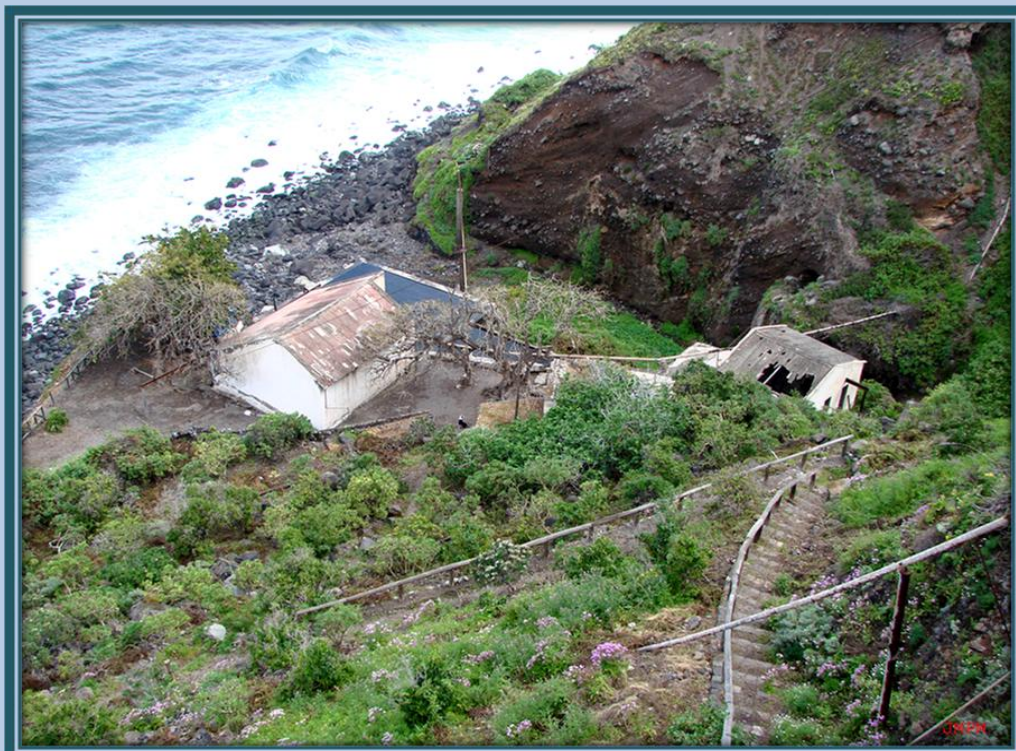
Caseta en estado casi ruinoso donde se encuentra el motor para elevar el agua y otra en estado de abandono.
