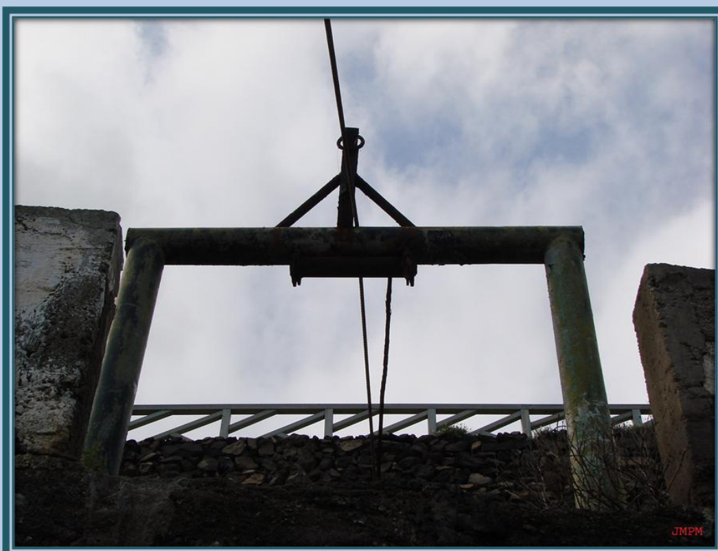
Se ha instalado un güinche para mejorar y facilitar la bajada y subida de materiales necesarios para el mantenimiento de la maquinaria que eleva el agua.
