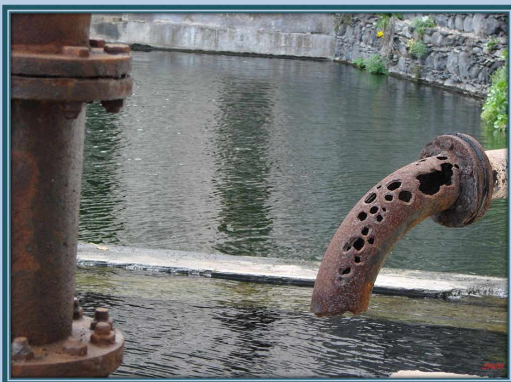
En la playa se encuentran dos estanques que almacenan el agua de los manantiales de la zona para luego ser elevada.
