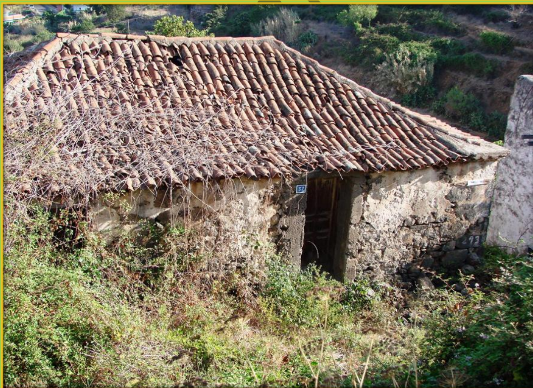
Desde el chorro anterior subimos unos pocos metros y tomamos la calle de Los Herreros. Vivienda rural tradicional canaria en estado de abandono.
