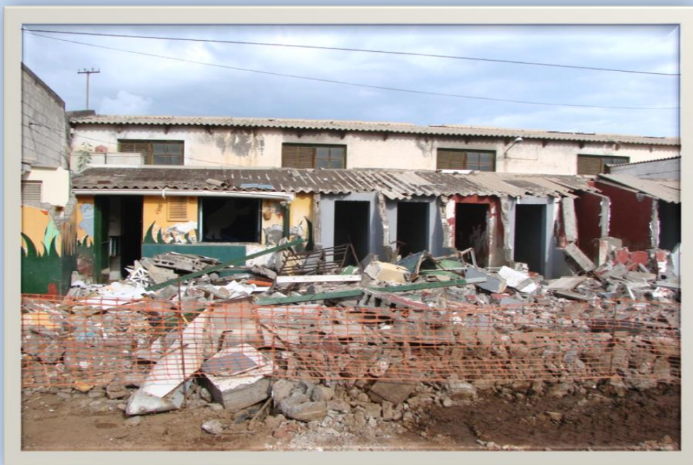
Antigua perrera de Punta Brava, desaparecida recientemente por la ampliación de la carretera.
