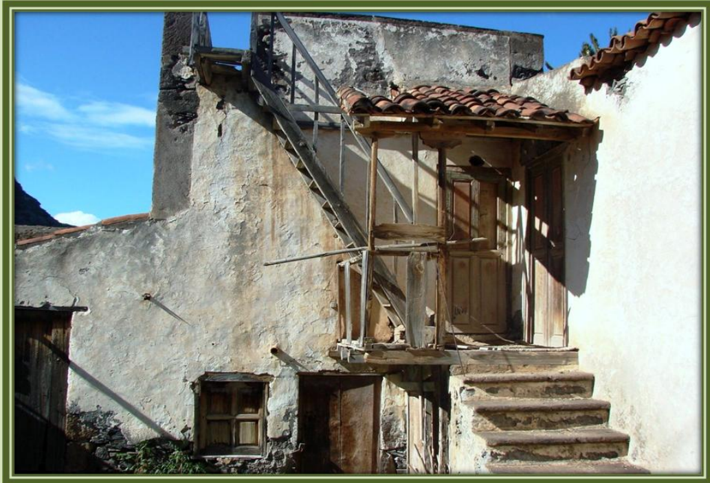
En el Drago nos encontramos con una antigua casa de dos plantas en muy mal estado de conservación.
